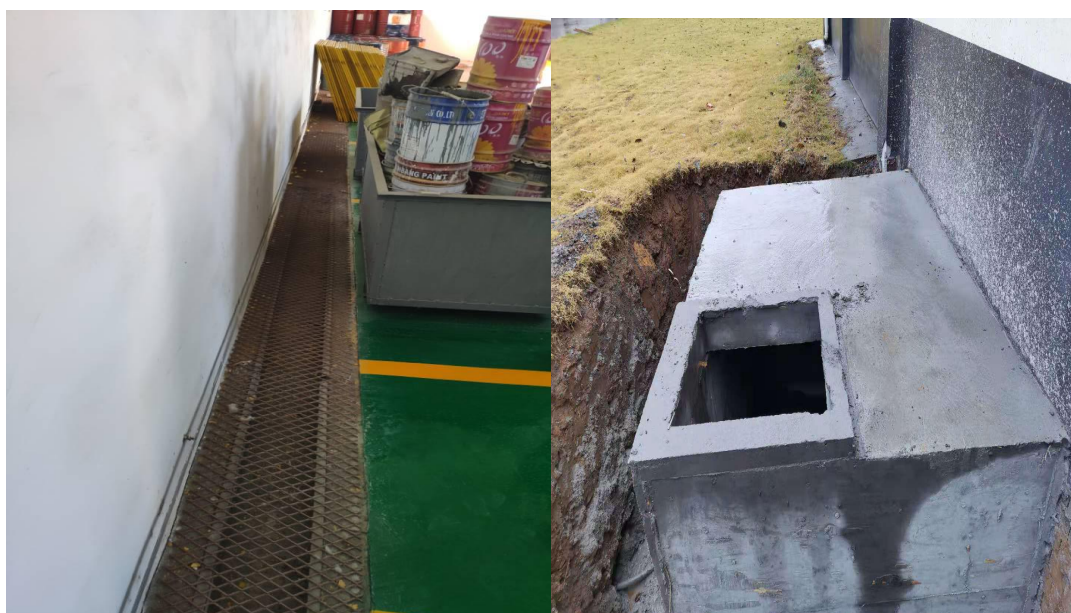
导流槽和应急池
