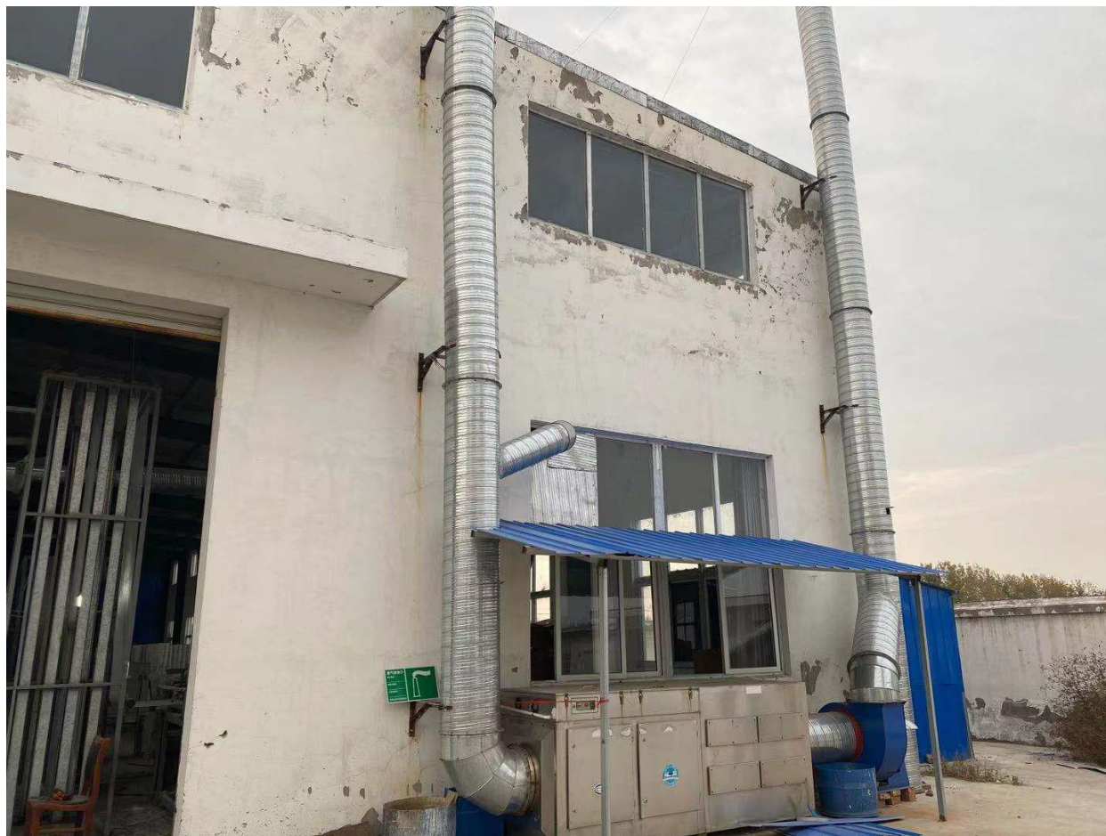
图 2-4 废气处理设施及 15 米高排气筒
