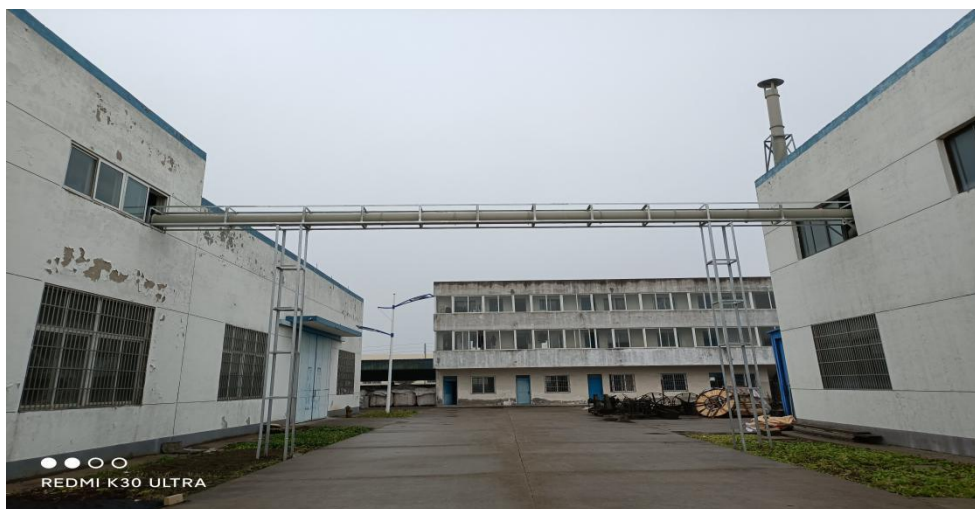
2#车间废气连接管道
