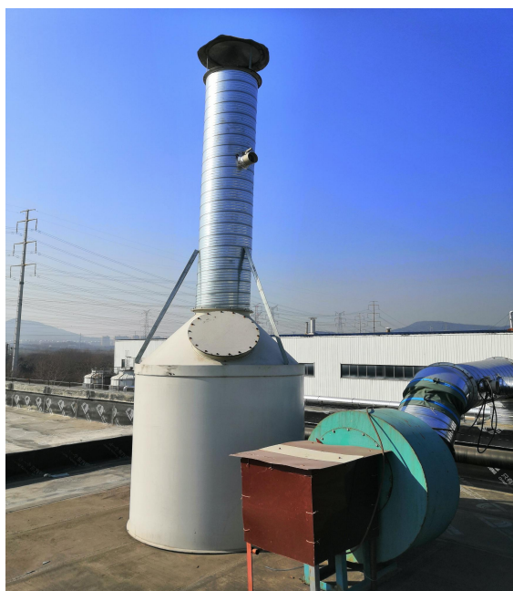
废气活性炭处理设施
