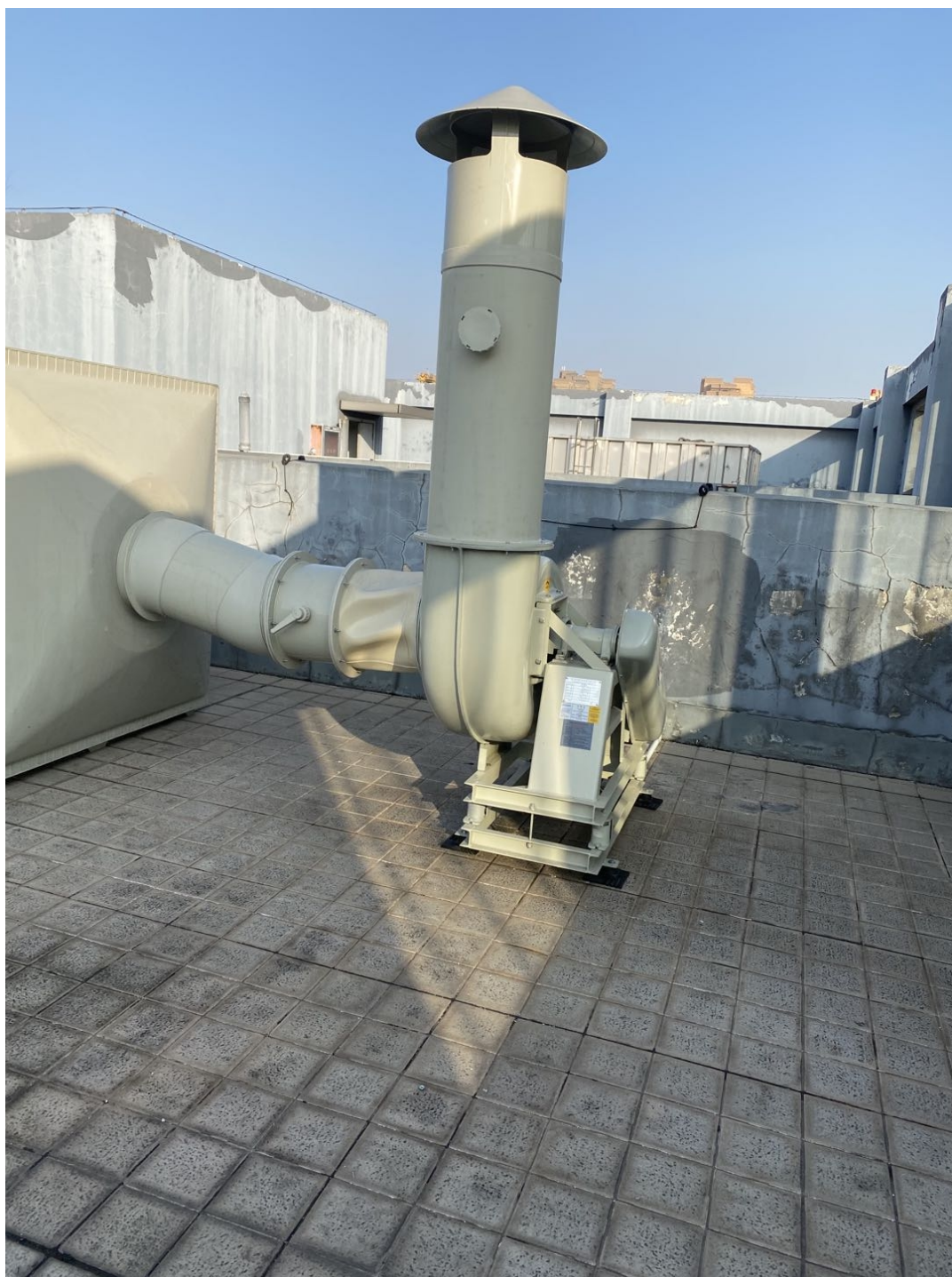
实验楼废气处理设施 FQ-1 排气筒
