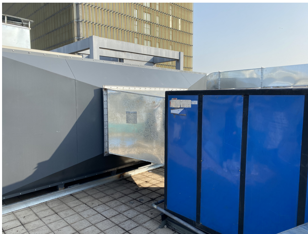
NF 动物设施楼动物房内恶臭气体处理设施 FQ-2 排气筒
