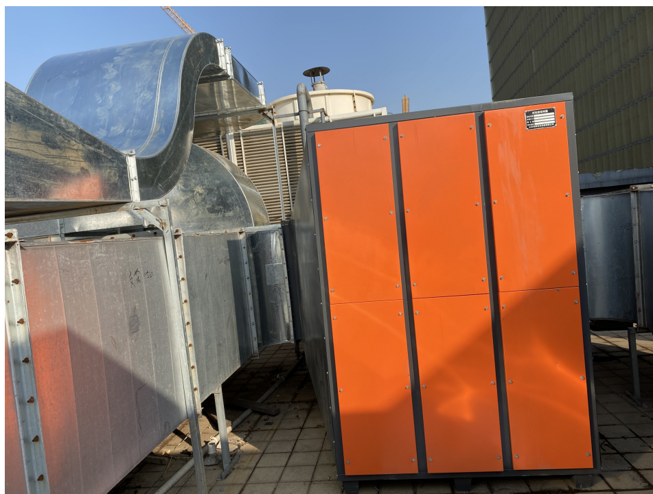
NF 动物设施楼动物房内恶臭气体处理设施 FQ-3 排气筒
