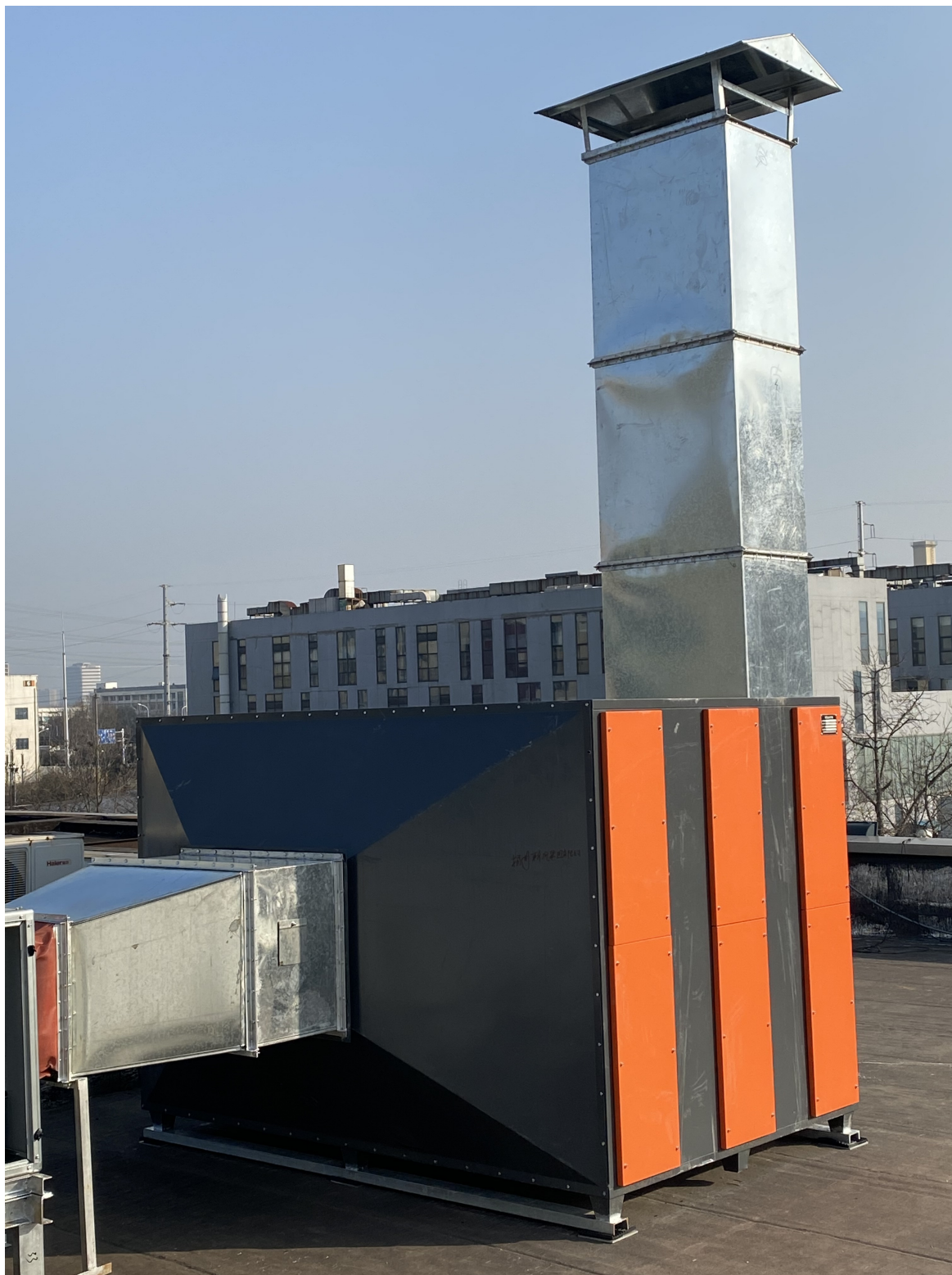
NRF 动物房废气处理设施 FQ-6（检测报告中为 FQ-10）排气筒
