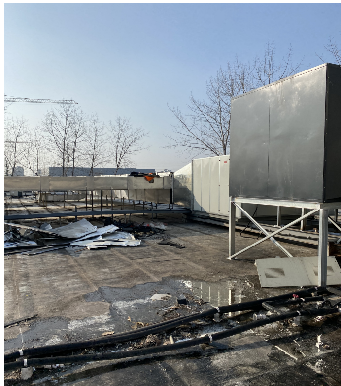
GF 动物房废气处理设施 FQ-5（检测报告中为 FQ-9）排气筒
