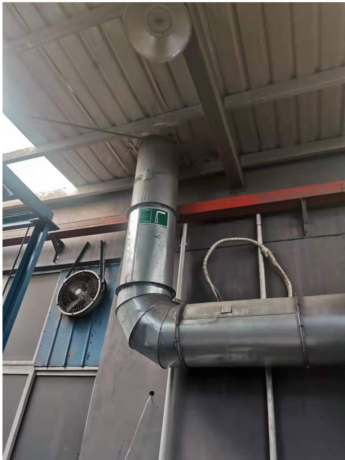
抛丸、喷砂处理设施废气排气筒
