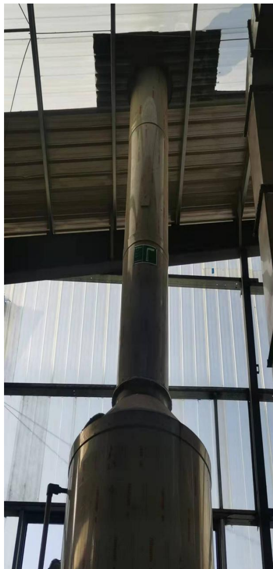
酸洗工序废气处理设施排气筒
