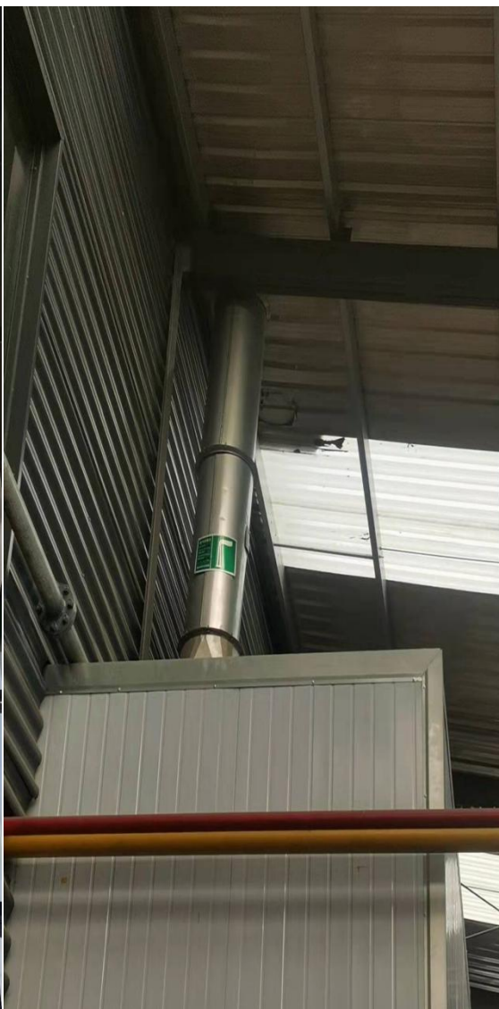
HCH 型燃烧机废气排气筒
