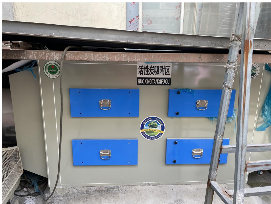
有机废气处理设施
