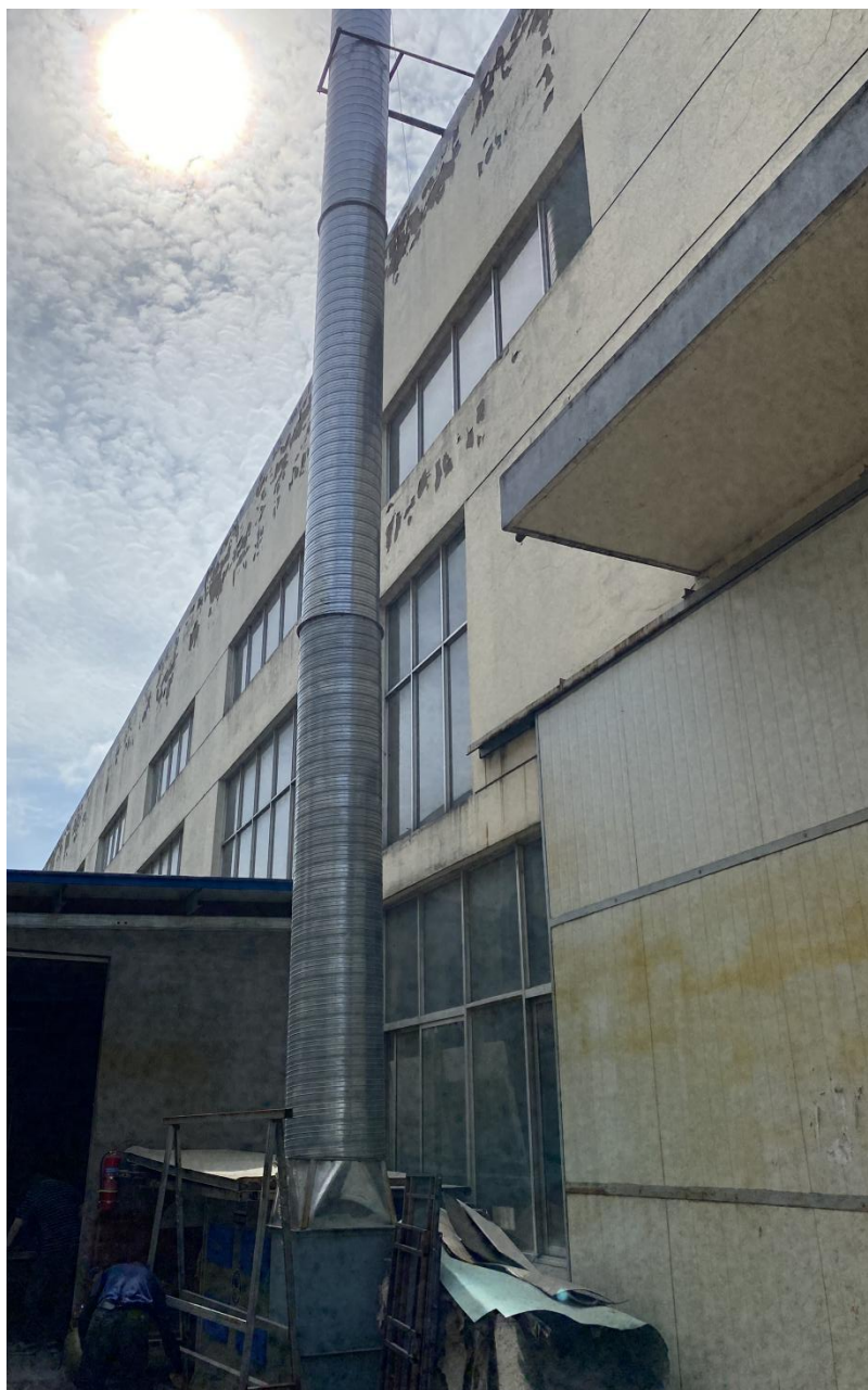
有机废气排气筒
