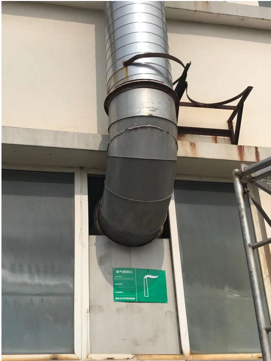
喷漆房废气排气筒
