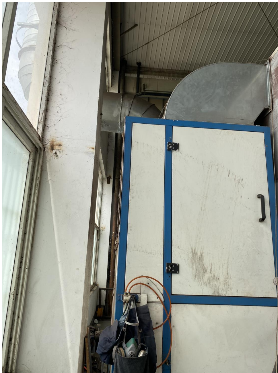
喷漆房废气处理设施
