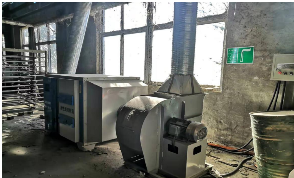
糊板、热压车间活性炭吸附装置
