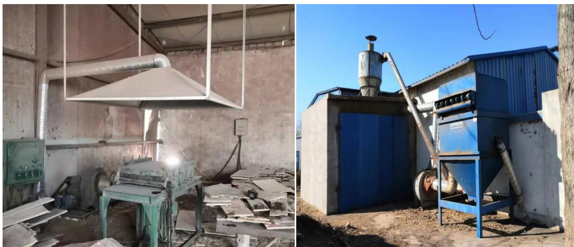
锯料车间集气罩+布袋除尘装置
