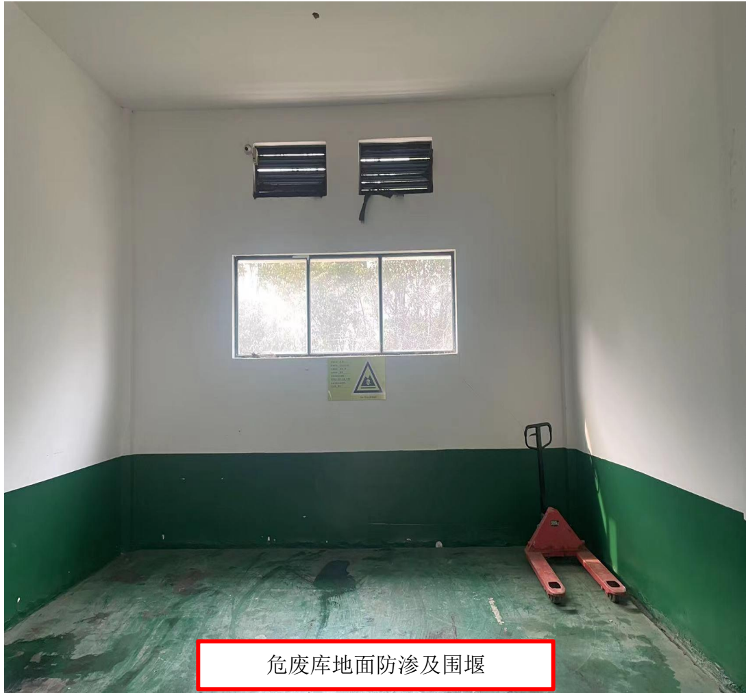
危废库相关图片
