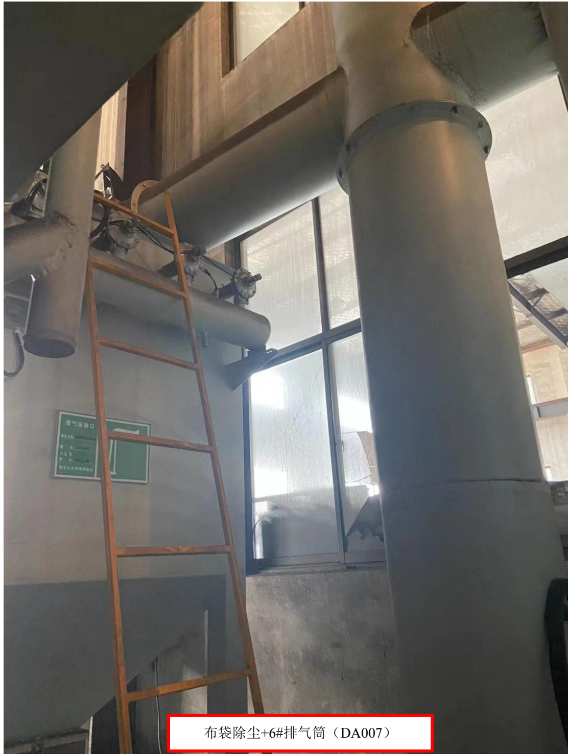
废气处理设施及排气筒图片
