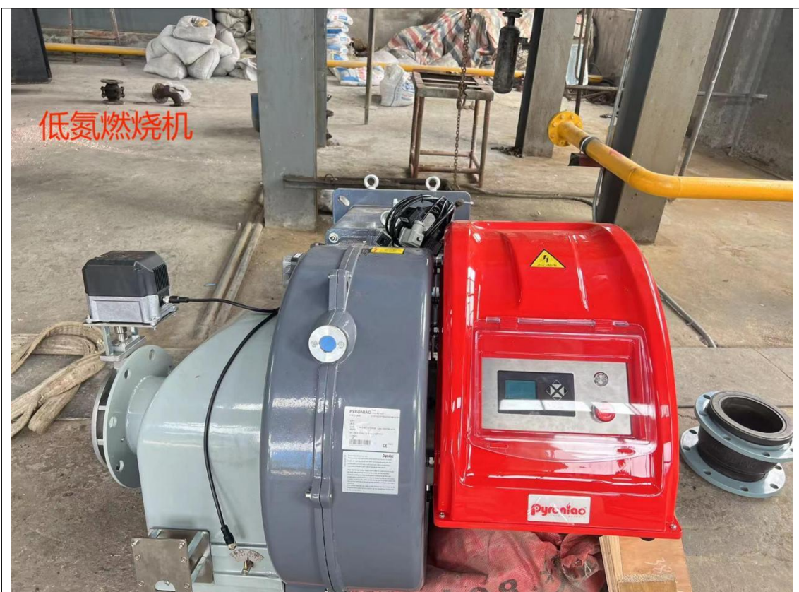
图 3-1 锅炉房废气处理设施（低氮燃烧器）
