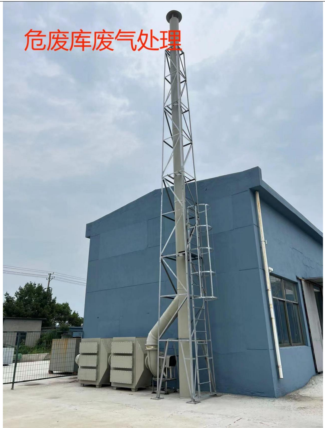
图 3-2 危废库有机废气废气处理设施
